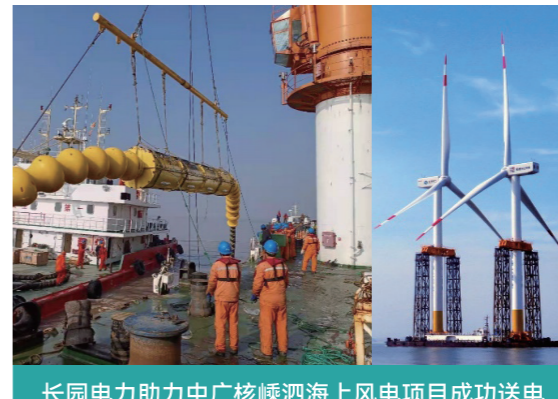
长园电力助力中广核嵊泗海上风电项目成功送电
