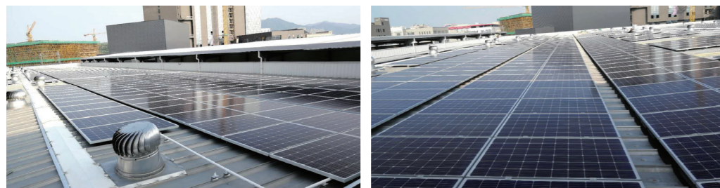
长园电力 分布式光伏建设
