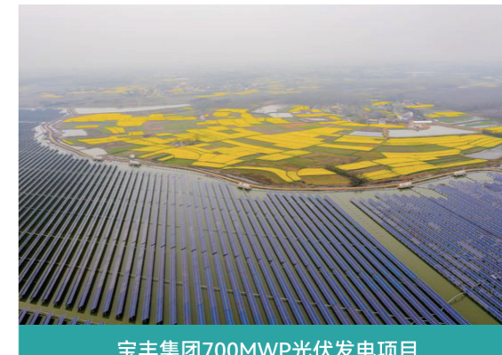
宝丰集团700MWP光伏发电项目
