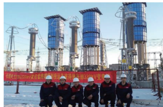
330kV俄罗斯圣彼得堡东部变电站项目
